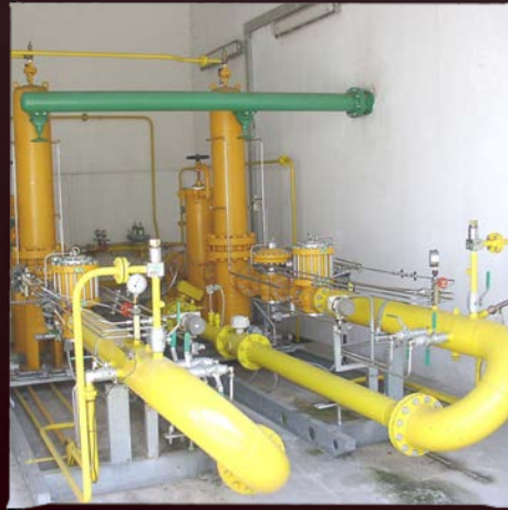
Gyál nyomásszabályozó állomás
