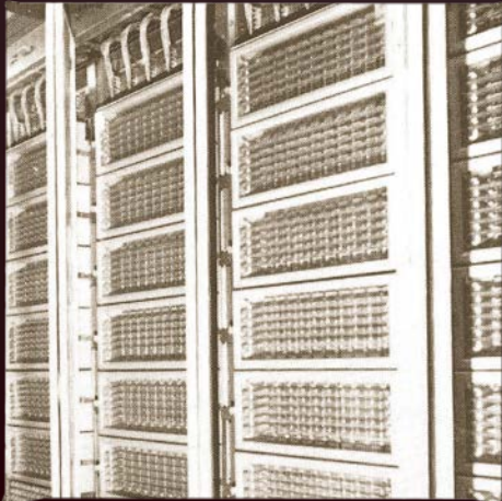
Crossbar kapcsoló gépek
