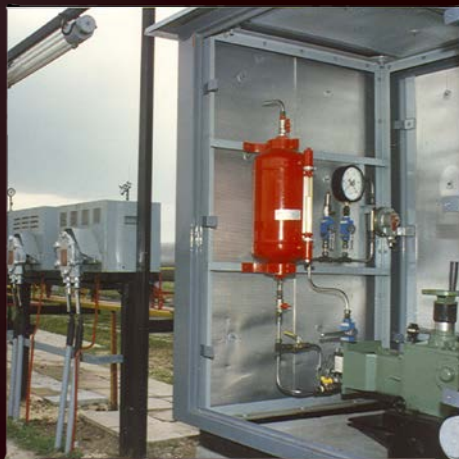
Zsámbok szagosítóállomás 4 db Doselektrix szagosító egységgel
